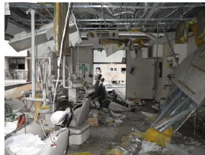
被災建築物内側
