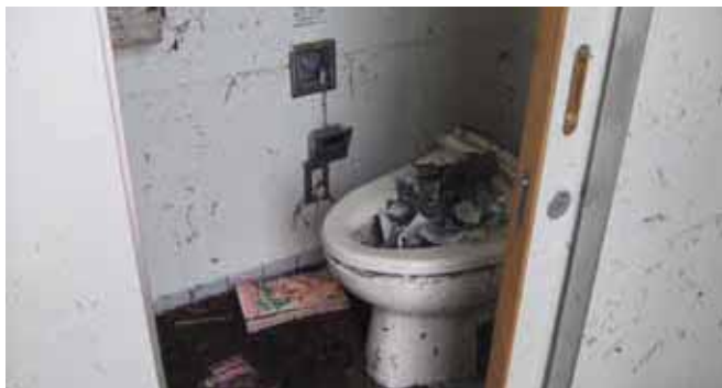
汚物が詰まったトイレ
