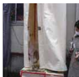
仮設トイレ(組立て型)
